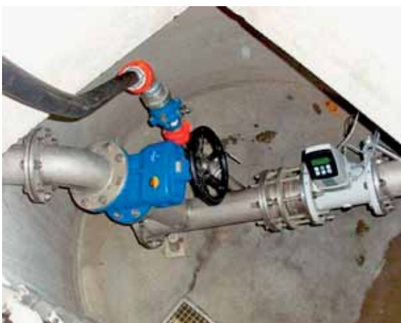
Abbildung 3: Einspeisestellen für Druckluft in Abwasserdruckleitungen an BEV oder an Entleerung
